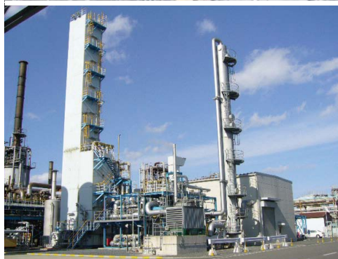
工業ガス製造設備
