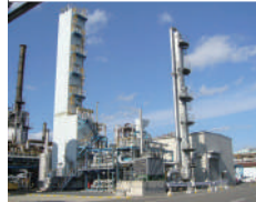
工業ガス製造設備
