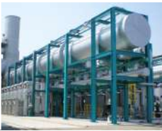
蒸気発生設備(LNG使用)
